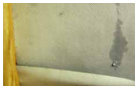
Poškození stěn v interiéru po vniknutí vody
