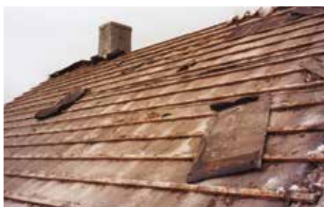
Zborcení konstrukce budovy působením hub a plísní
